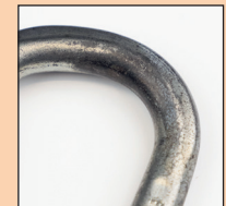
oberflächliche Korrosion an Stahl
